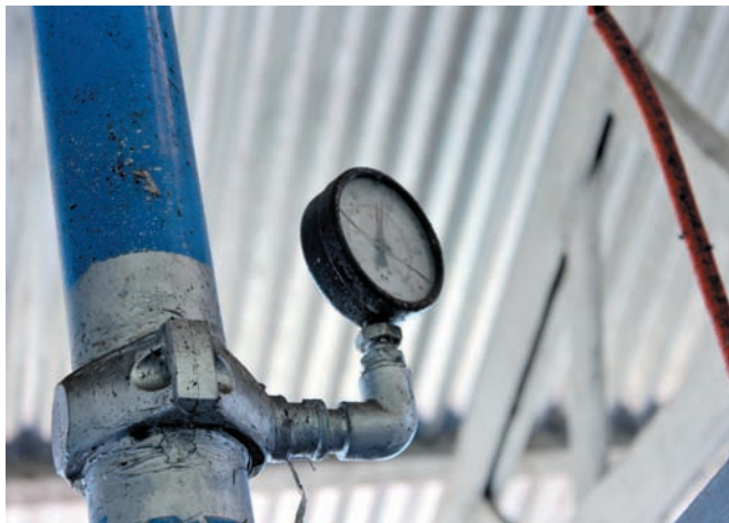
Figura 7. Manómetro en malas condiciones de funcionalidad.
