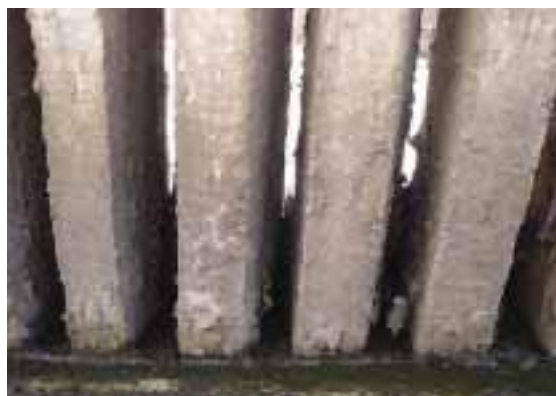
Foto 4.8. Detalle de separación entre columnas.
