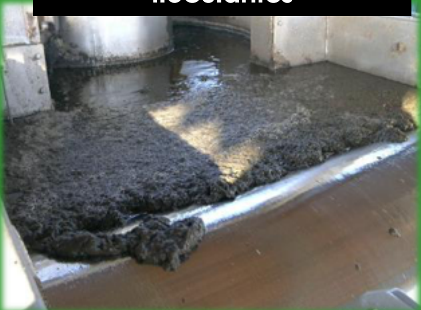
Tratamientos con floculantes
