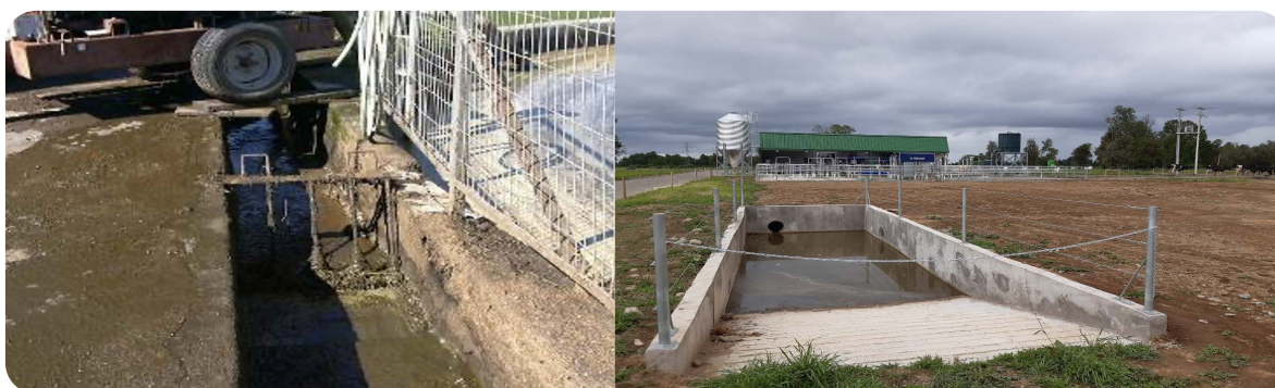
Figura 6. Reja en canal purinero para evitar ingreso de materiales ajenos al purín (Foto lado izquierdo) y trampa de piedras y arena (Foto lado derecho).
